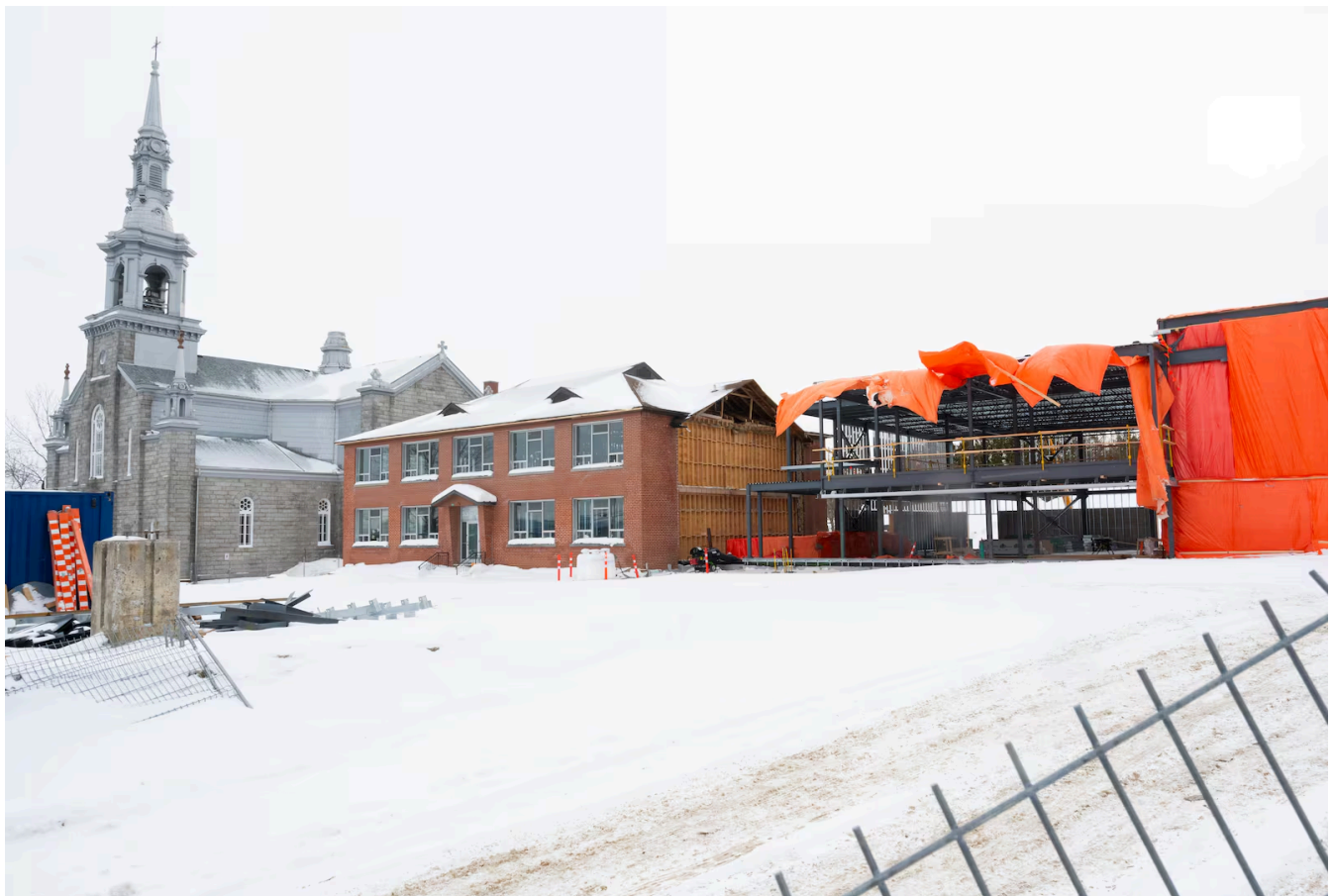
Le pavillon 1 (à gauche près de l'église) a d'importants problèmes de structure. (Maxime Picard/La Tribune)
